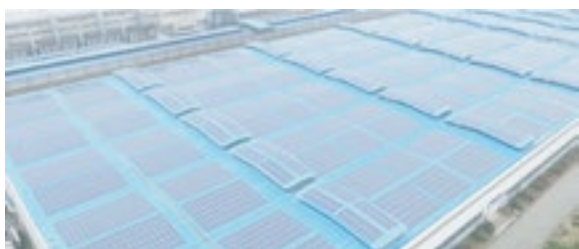
台州29.49MWp屋顶光伏项目
