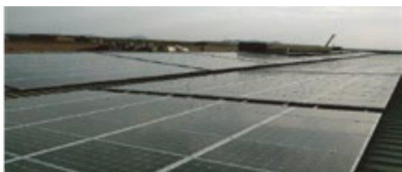
宁波9.5MWp屋顶光伏项目
